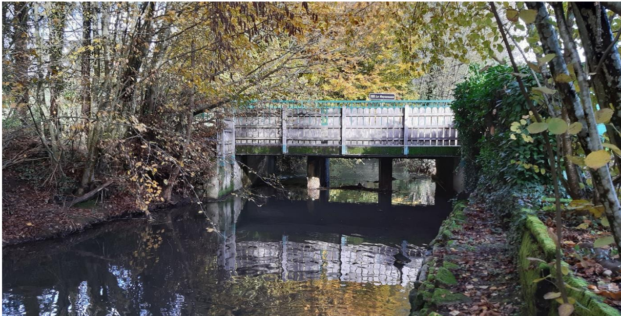
Photographie du pont depuis l'amont de la Reyssouze datée du 16/11/2022 (source : ABO-ERG)
