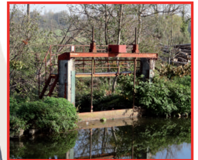
Vanne guillotine à l'entrée de la Morte
