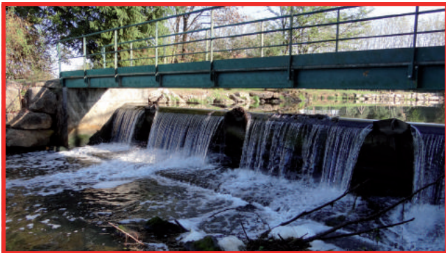
Vanne clapet sur la Reyssouze
