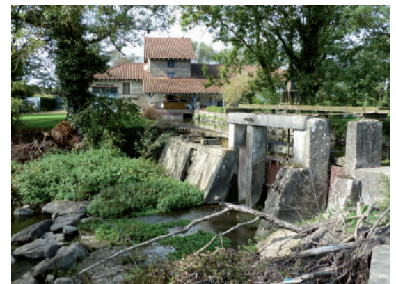
Vanne du moulin Peloux à supprimer et aménager
